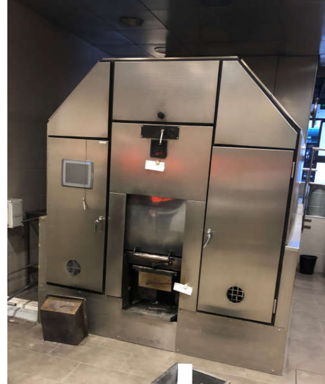
Huollamme myös muiden laitteita - Hyvinkää Service other brands - Hyvinkää
